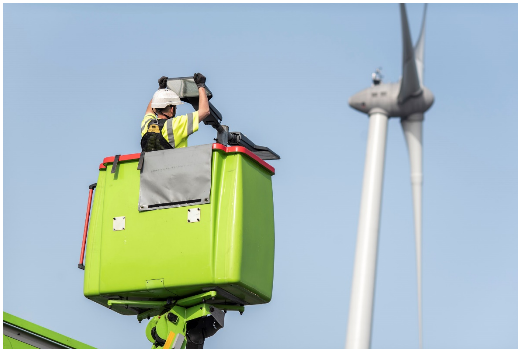
Verleding van de openbare verlichting in het Antwerpse havengebied
